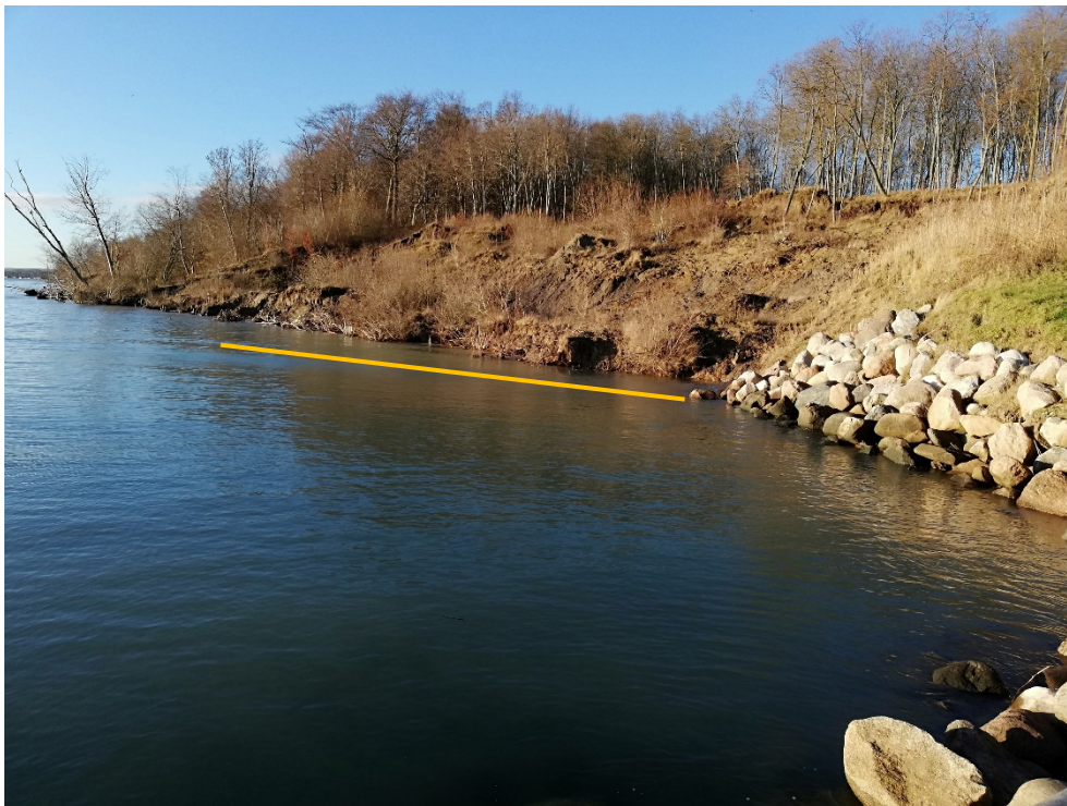
Figur 4. Det ses, at den aktuelle strækning der ønskes beskyttet af kystsikring er mere udsat for erosion end strækningen syd for (tv i foto).
