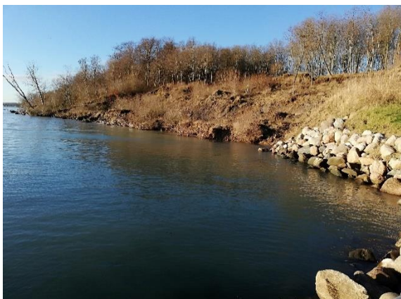
Foto 1. Projektstrækning ved højvande set mod syd fra badebro (2018). Det ses at skrænten eroderes på strækning uden kystbeskyttelses anlæg.
